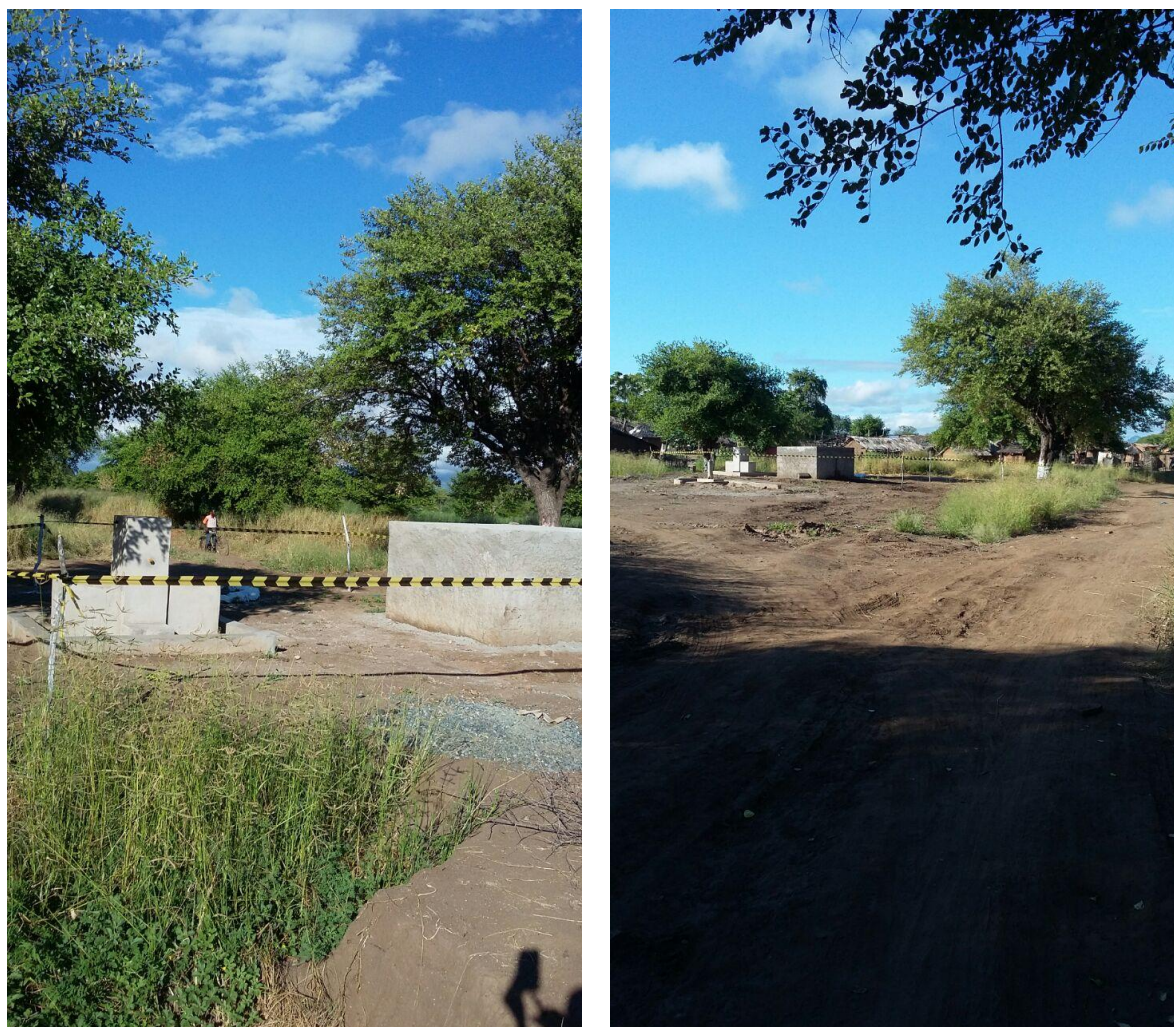
Figura 06 e 07: “Fontenária” construída para um sistema de canalização e fornecimento permanente de água à comunidade.
